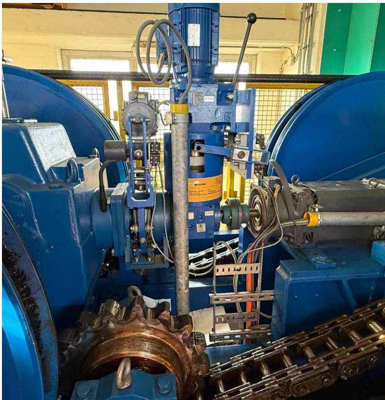
Aandrijving bovenhoofd hefdeur sluis Lith
