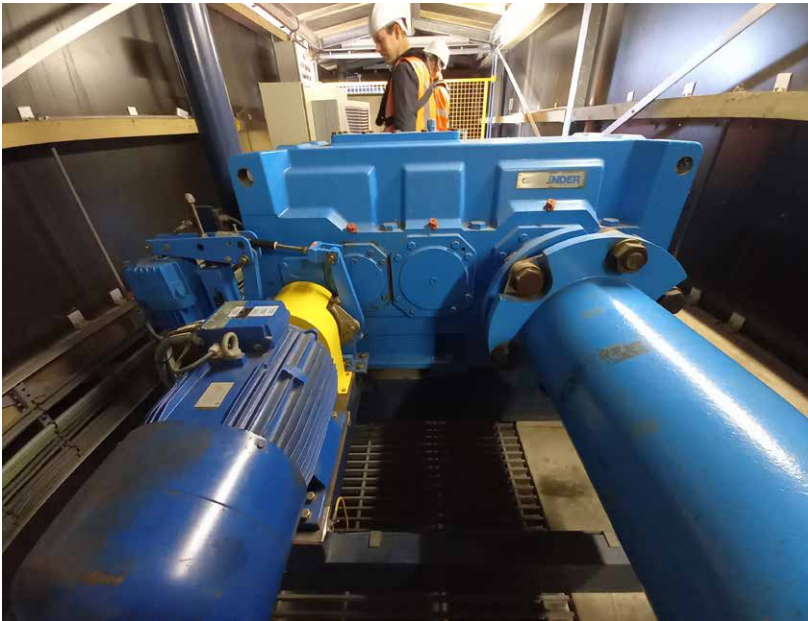
Aandrijving hefbrug Sluis Complex St. Andries
